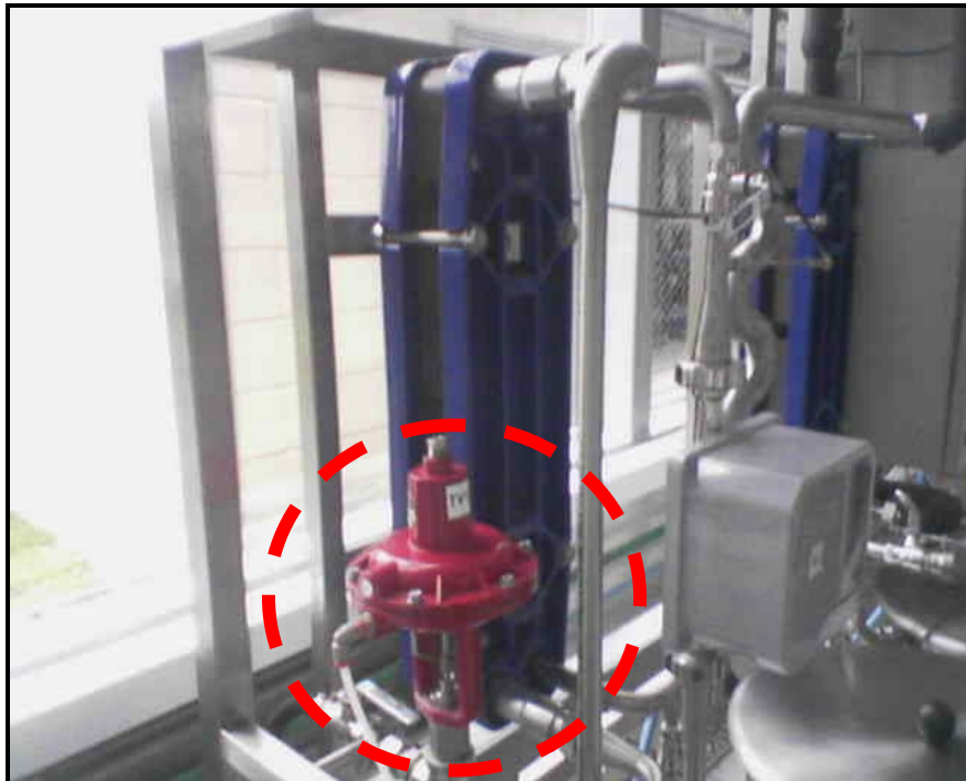
FIGURA 2 – Setor de aquecimento do trocador de calor de placas. No destaque encontra-se a válvula automática de controle de entrada de água quente.
